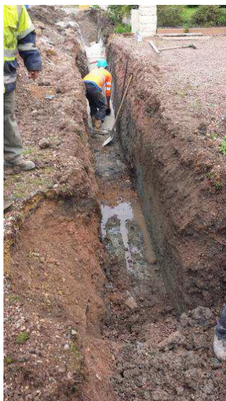
Conduite de transfert des eaux usées vers la STEP
